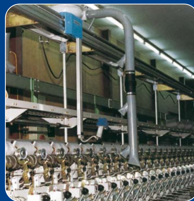
ATS tipo "C" con Jointair 115 installato su una accoppiatrice dotata di soffiatore mobile
